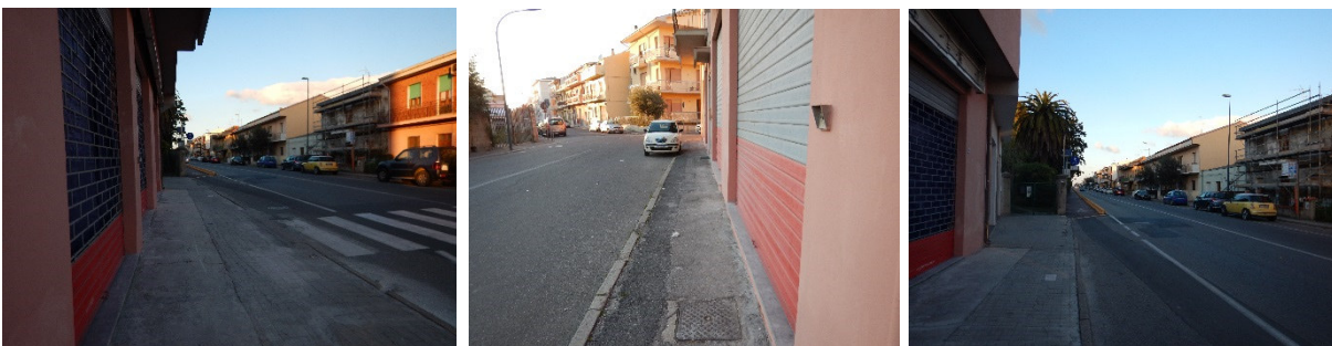
Figura 4 Viste dello stato di degrado dei marciapiedi e vista della pista ciclabile in Via Casu
