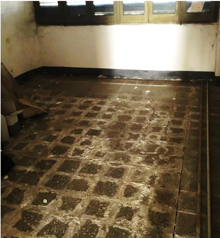
3- lesione continua nel pavimento per cedimento del massetto
