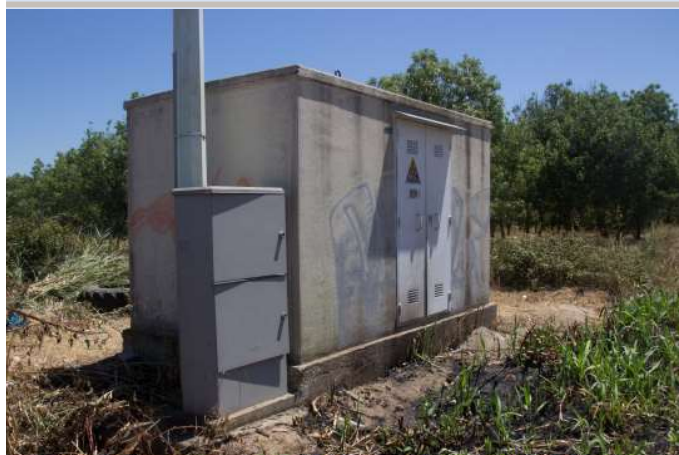
Cabina enel in muratura
