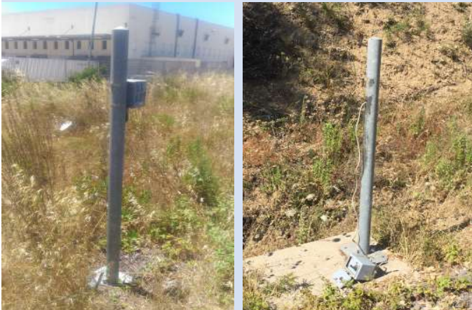
Colonnina elettrica in acciaio e base in cls
