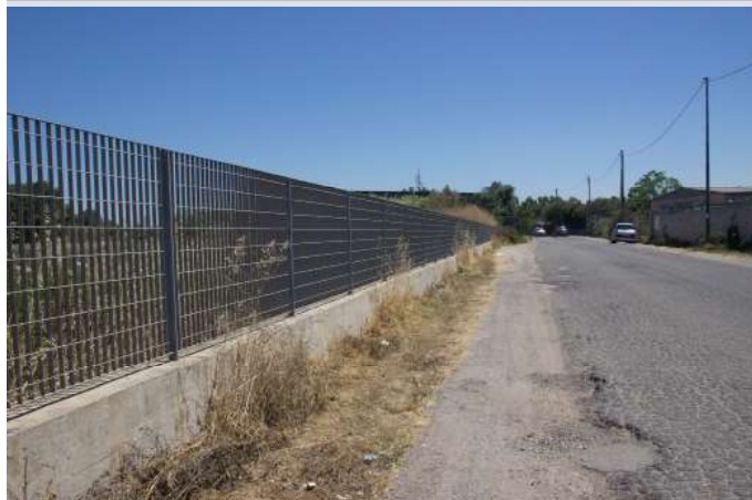
Pannelli recinzione tipo Orsogril
