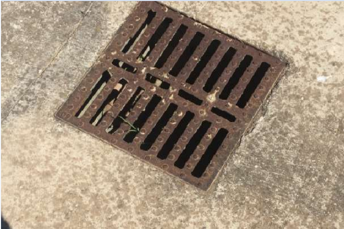
Pozzetto scolo acque bianche
