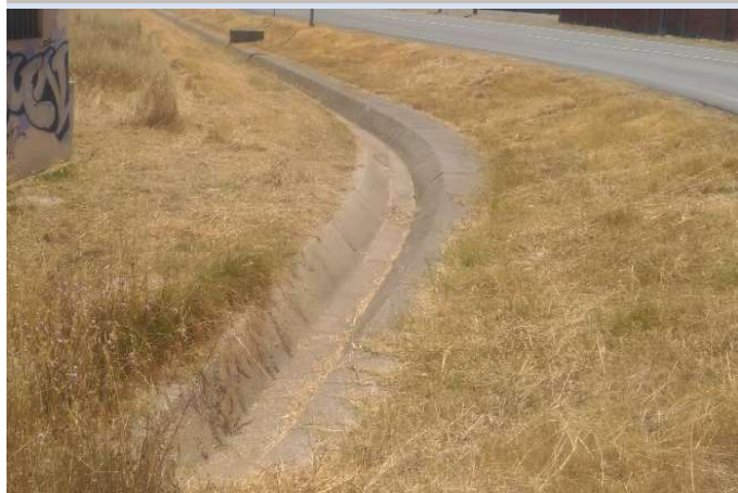
Canale di scolo in cls prefabbricato
