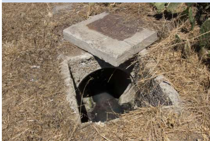
Pozzetto di ispezione con coperchio in ghisa
