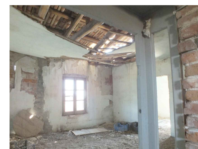
5_Cracks di controsoffitto
