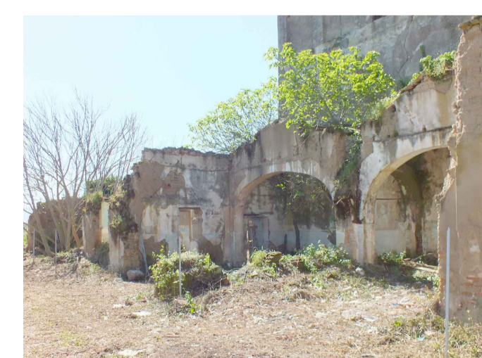
Mancanza di materiale nel corpo delle scuderie
