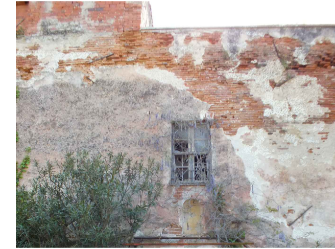
Mancanza di materiale nel prospetto principale
