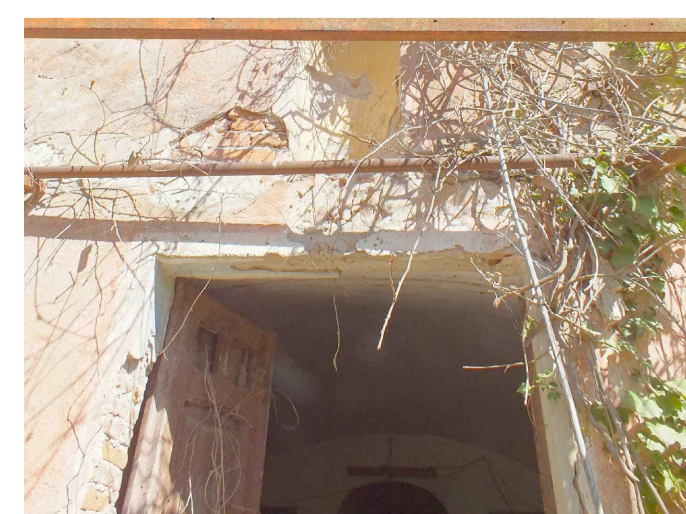
2_Perdita di intonaco
