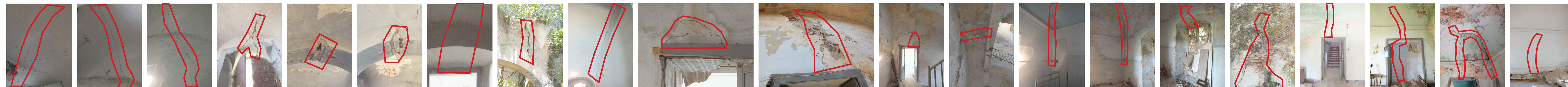
1, Lesione visibile su un solo paramento murario 2, Lesione visibile su un solo paramento murario 3, Lesione visibile su un solo paramento murario 4, Lesione passante 5, Lesione visibile su un solo paramento murario 6, Lesione passante 7, Lesione visibile su un solo paramento murario 8, Lesione passante 9, Lesione visibile su un solo paramento murario 10, Lesione passante 11, Lesione passante 12, Lesione passante 13, Lesione visibile su un solo paramento murario 14, Lesione visibile su un solo paramento murario 15, Lesione visibile su un solo paramento murario 16, Lesione passante 17, Lesione passante con distacco macroscopico delle parti 18, Lesione visibile su un solo paramento murario 19, Lesione visibile su un solo paramento murario 20, Lesione visibile su un solo paramento murario 21, Lesione visibile su un solo paramento murario
